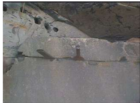
séparation d'une levée
